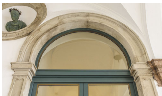
Die Sandsteingewände der Durchgänge machten die Befestigung der Brandschutzelemente zu einem Sonderfall
